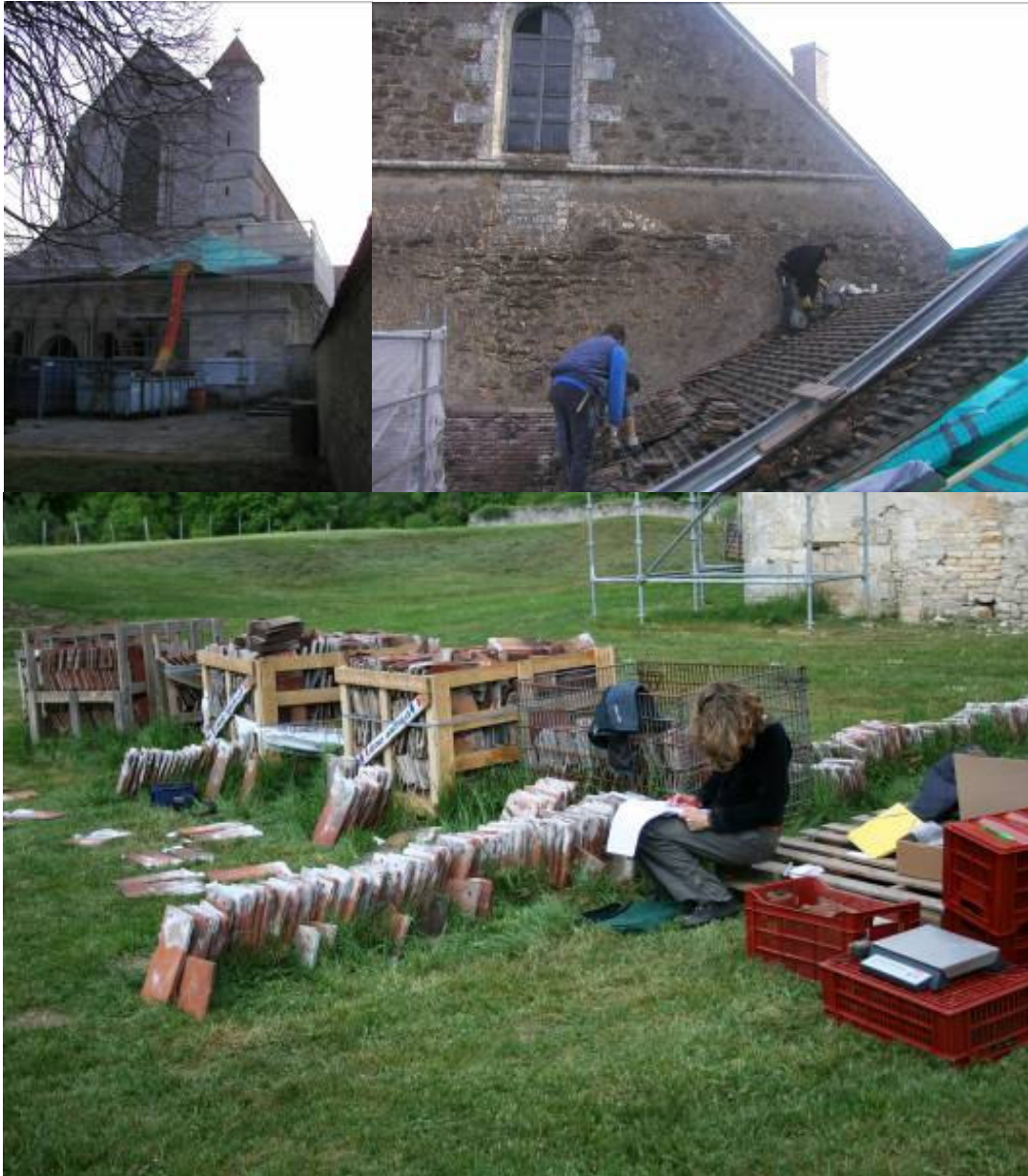
Fig. 11 : L'archéologie des couvertures de monuments : deux conditions d'intervention différentes. En haut, les tuiles ne seront pas réutilisées sur la toiture et le travail de typologie doit se faire sur l'échafaudage avec les couvreurs, avant l'évacuation des matériaux dans la goutte menant à la benne. En bas, les tuiles doivent faire l'objet d'une étude morphologique poussée car elles seront posées une nouvelle fois (cl. S. Aumard).
