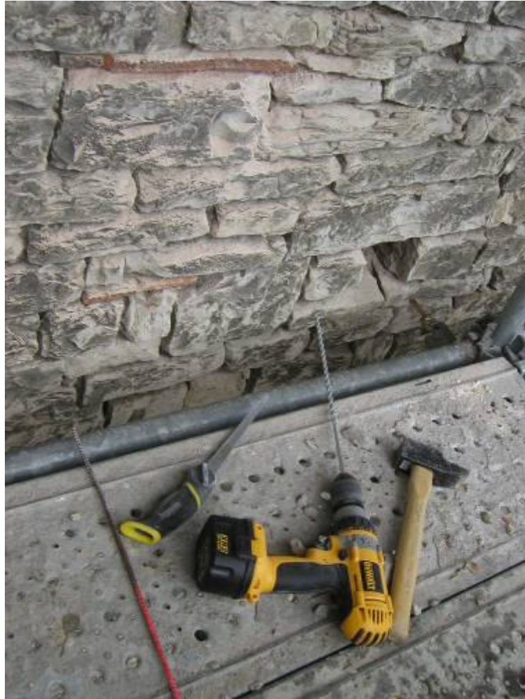
Fig. 4 : Un petit équipement composé principalement d'une lame de scie et d'une perceuse munie d'une grande mèche permet de découper le mortier autour des tuiles remployées dans les maçonneries. Combinée à l'analyse des élévations, cette technique permet d'alimenter efficacement les typoschronologies (cl. S. Aumard).
