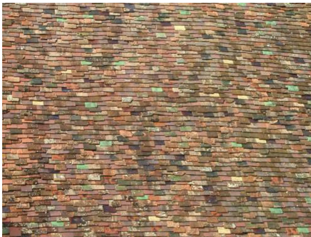
Fig. 2 : Auxerre (Yonne), cathédrale Saint-Étienne, toiture du chœur. La diversité des coloris et des formats illustre les réparations successives depuis l'origine de la couverture et indique un fort potentiel historique (cl. S. Aumard).
