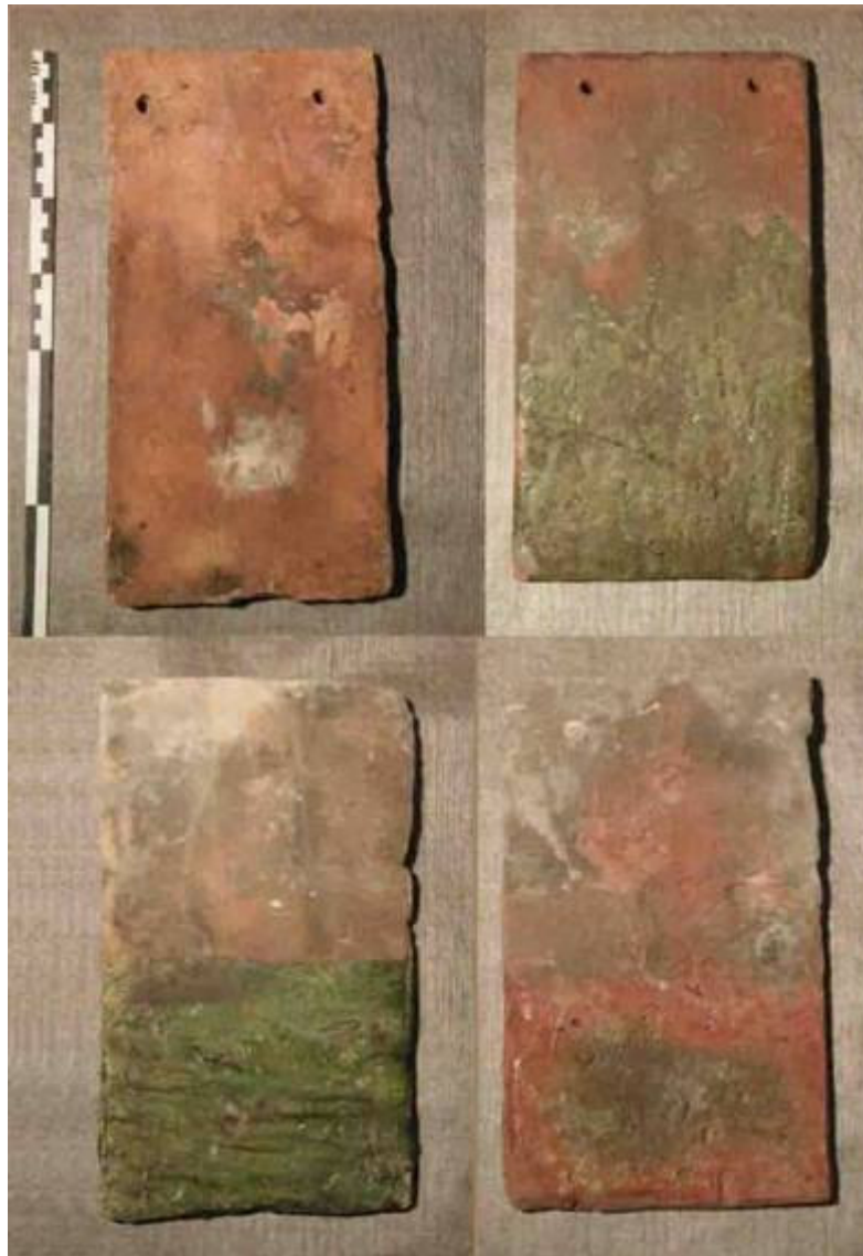
Fig. 3 : Auxerre (Yonne), cathédrale Saint-Étienne, tuiles de la couverture du grand comble de la nef. En haut, tuiles sans crochet : à g., type à épaisseur fine et pureau brute (A1) ; à dr., type épais à pureau glaçuré vert (A2). En bas, tuiles à crochet : à g., type à pâte beige et pureau glaçuré vert (B) ; à dr., type à pâte orange et pureau glaçuré vert, jaune, orange ou marron (cl. S. Aumard).
